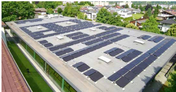
Von unten kaum sichtbar, erzeugt die neue PV-Anlage auf der Sporthalle Höralt 145 kWp
