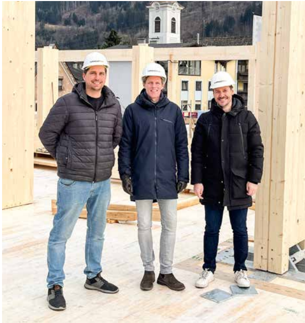
Ausschussobmann Christoph Müller, Bürgermeister Lukas Schmied und Abteilungsleiter Dietmar Pregonzer (v.l.) bei einem Baustellenbesuch Mitte März
